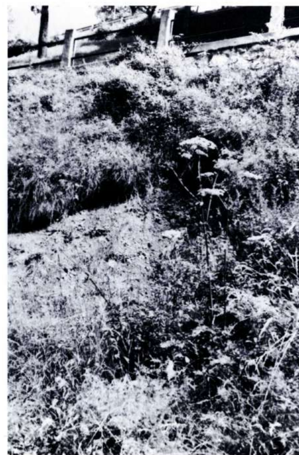
Fig. 1 - Dissesto ubicato in corrispondenza di un'incisione morfologica. Si nota il processo erosivo in atto al di sotto della zolla erbosa. - Landslide located in a morphologic incision. It is possible to see the erosive process under the turfs.
